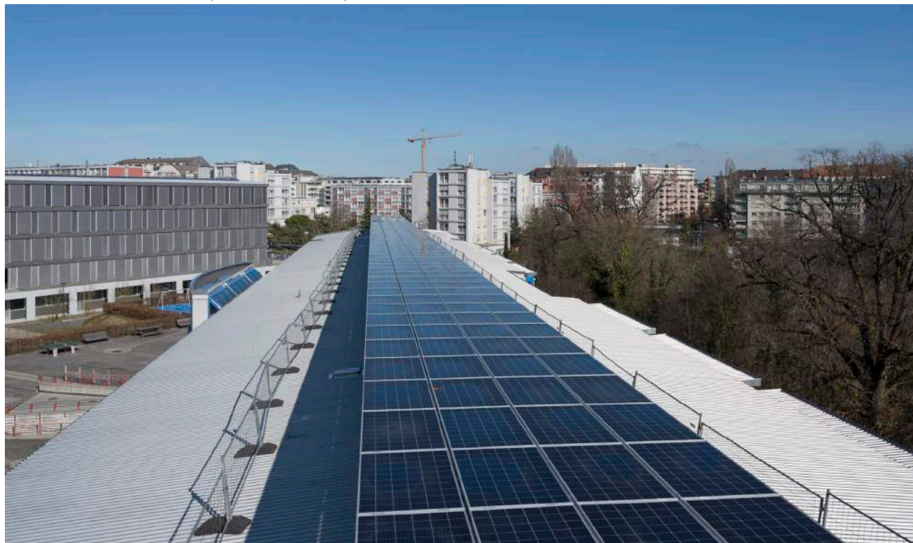
Panneaux solaires sur la toiture du cycle d'orientation de Cayla
